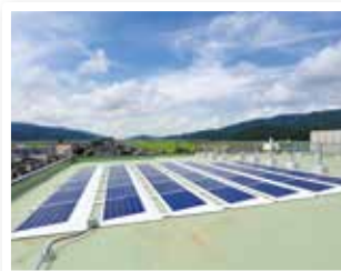
屋上の太陽光発電システム
